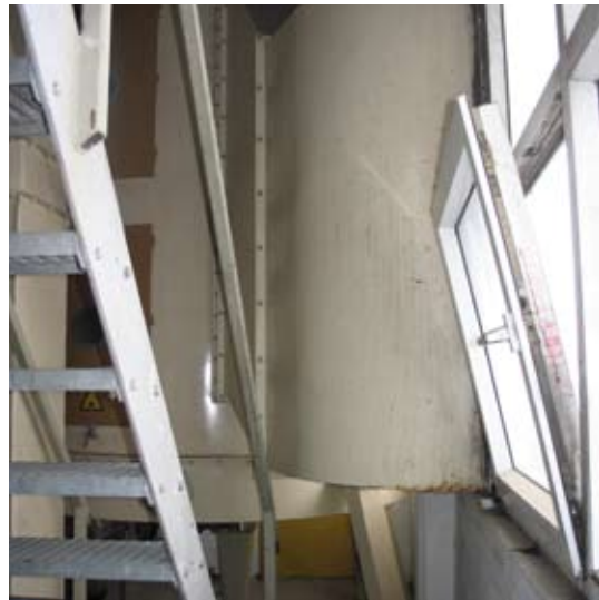
Eksplodingsaflastning på dette anlæg til melproduktion er ført ud gennem væggen. Anlægget er placeret højt oppe i mølleriet, og en evt. eksplosion vil derfor ikke sende flammer ud i personhøjde.
