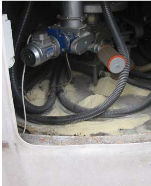
I rummet under siloerne er der installeret elektrisk materiel. Der ligger små mængder mel på gulvet i rummet, der dog ikke vurderes at kunne give anledning til eksplosiv atmosfære.
