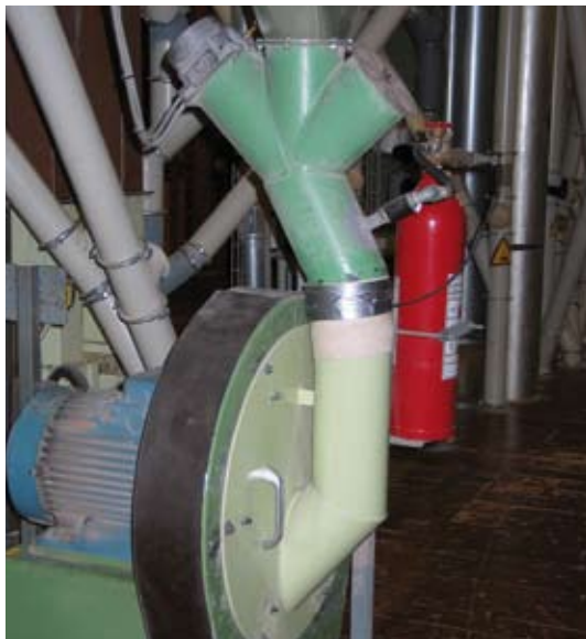
På slaglemollen til formaling af grove skaldele fra melproduktion er der monteret gnistdetektion og CO 2 -slukning, da der her er risiko for metalrester i materialet (og dermed gnistdannelse).
